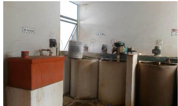
Figura 34 - Tanques de Sulfato, Cal e flúor
