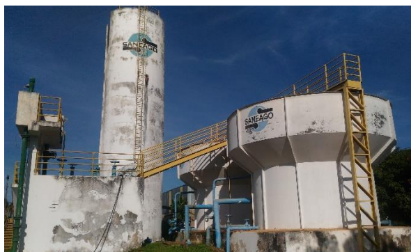
Figura 29 - Estação de tratamento de água de Orizona.
