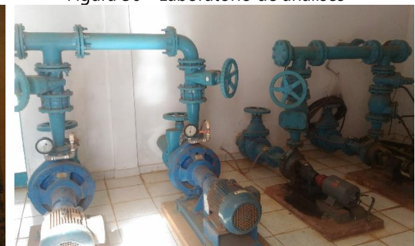
Figura 38 - Bombas na ETA
